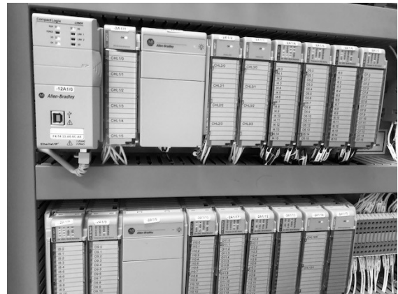
Abb. 2: SPS (speicherprogrammierte Steuerung) der Anlage. (Quelle: [-ING])
